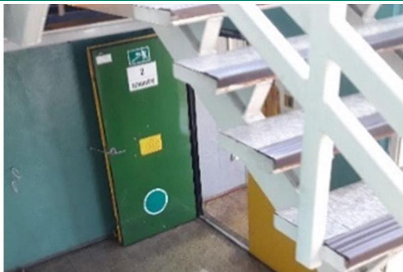
Neuzavřené protipožární dveře, zajištěné v otevřené poloze.
